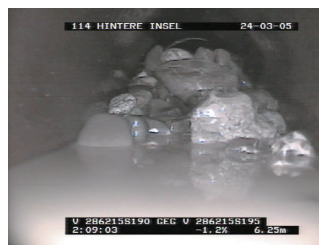
Kanalschaden durch Scherbenbildung - dadurch Kieseinbruch.
