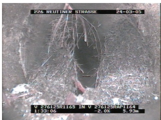
Bild 1: Kanalschaden durch Wurzeleinwuchs.
