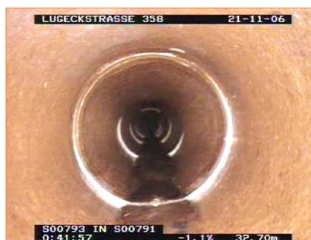
Bild: Intakter Steinzeugkanal
