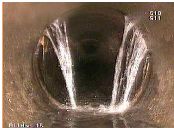
Bild: Fremdwasserzulauf im undichten Kanal
